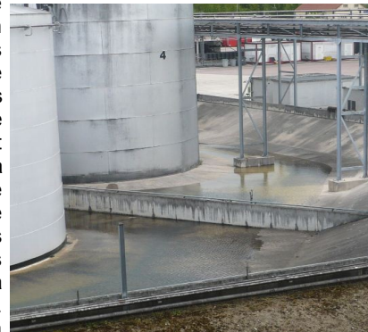
Rétention de bac non étanche (Source DREAL Champagne Ardenne)
