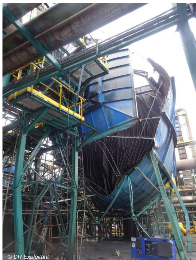
Figure 6 : État du dégoudronneur DE3 après le sinistre
