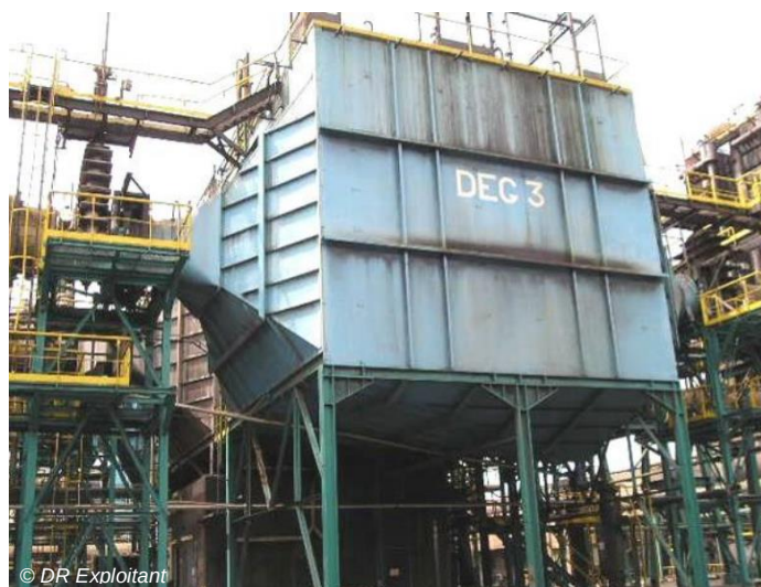
Figure 5 : État initial du dégoudronneur DE3 avant explosion
